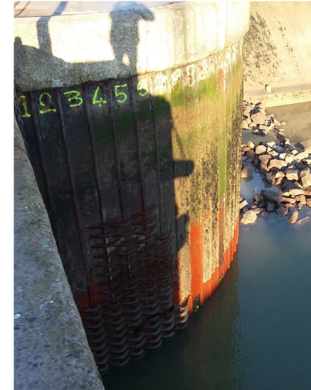
Figure 7 : photo du gabion et des reprises de serrures ouvertes
